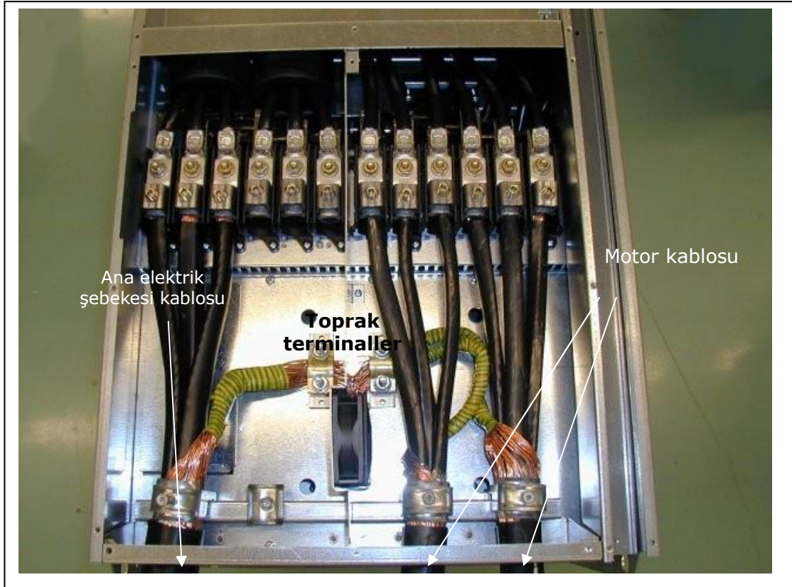
Şekil 6-17. Vacon NX, FR9'de kablo kurulumu
